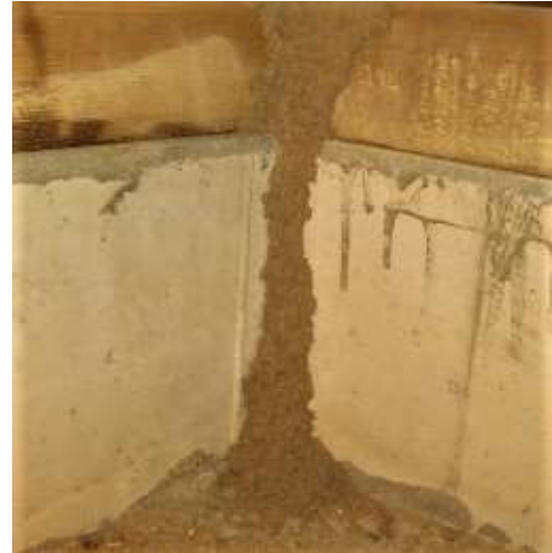
床下から土台に伸びる蟻道
