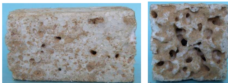
シロアリに加害された断熱材
